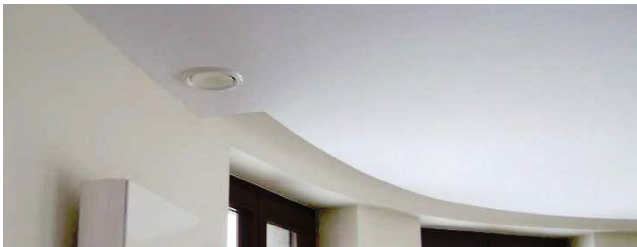
Anemostat nawiewny na suficie w pomieszczeniu z wentylacją mechaniczną.
