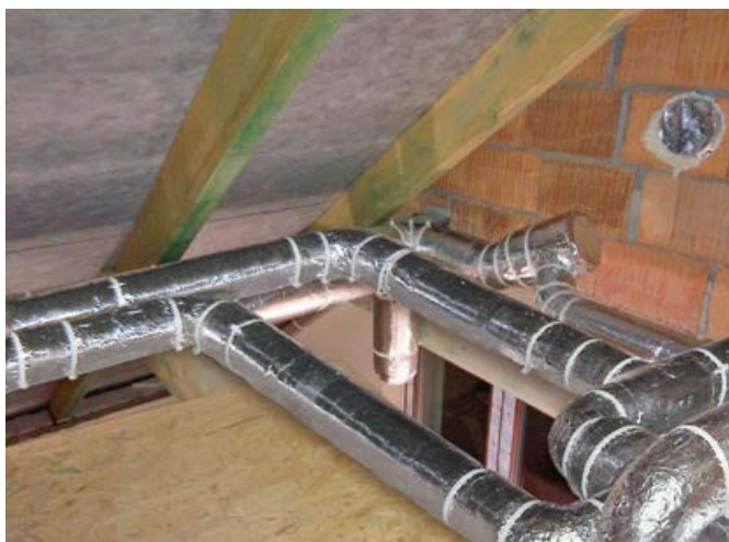
Instalacja rekuperacji zbudowana z kanałów wentylacyjnych stalowych w pomieszczenia na poddaszu.
