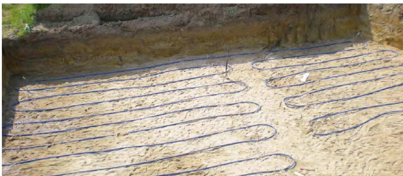
Zewnętrzna instalacja gruntowego glikolowego wymiennika ciepła.
